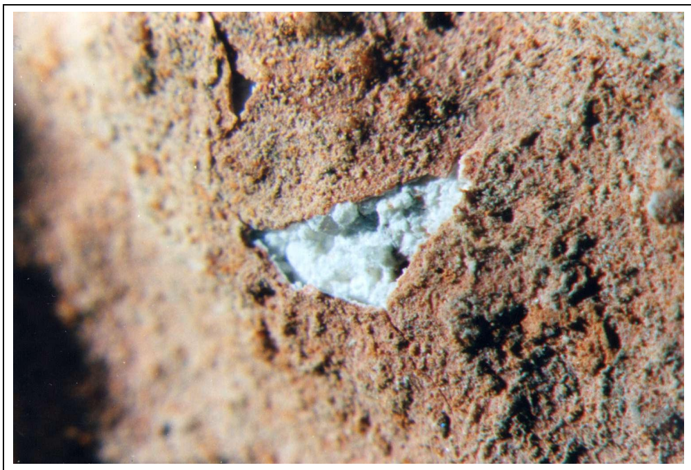
Abb. 18: S11 oberhalb der Horizontalsperre: Bei S11 platzt die obere Schicht über der weißen Zwischenschicht schollenartig auf (20-fache Vergrößerung).
