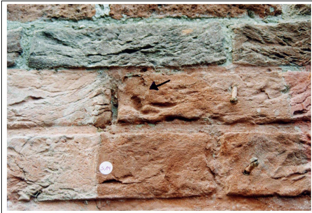
Abb. 11: S14 oberhalb der Horizontalsperre: Abplatzungen mit Ziegelverlust im Übergangsbereich der Schlämme 14 und ungeschlämmter Ziegel nach 2½ Jahren Standzeit
