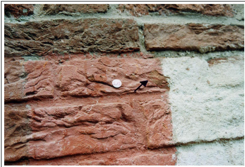
Abb. 12: S15 oberhalb der Horizontalsperre: Abplatzungen mit Ziegelverlust im Übergangsbereich der Schlämme 15 und ungeschlämmter Ziegel nach 2½ Jahren Standzeit
