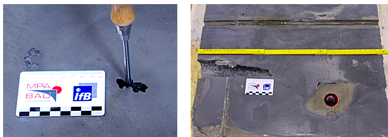
(a) Luft einschüsse auf der Vorderseite (b) Teil einer Luftblase auf der Rückseite
