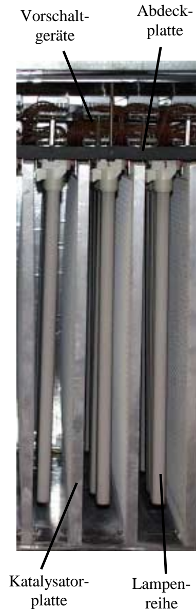
Abb. 5.3 Anordnung der Katalysatorplatten und Lampen (im Bau)
