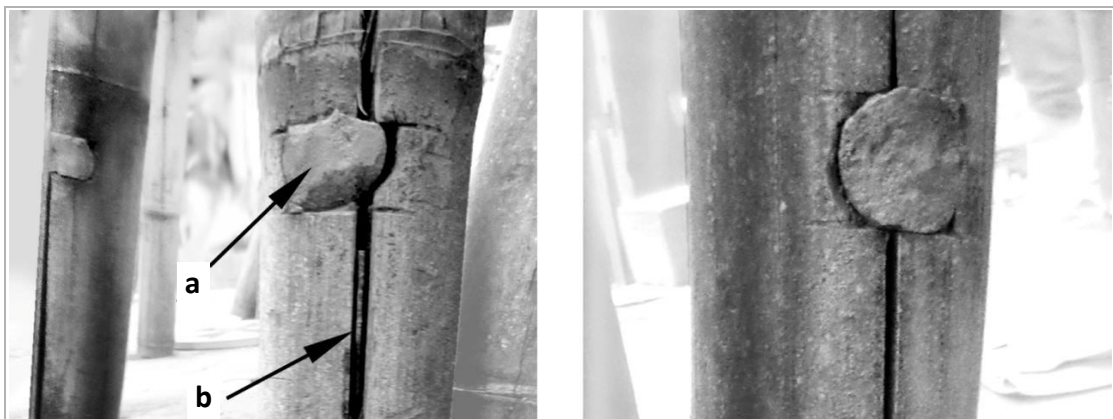
Abb. 53: Schädigung des Halms durch Mörtelfüllung der Halmkammer. a) Die Einfüllöffnung stellt eine deutlich größere Schwächung des Halmmantels als ein Dübelloch dar. b) Querzugversagen durch Schwinden der Halmwand nach Aushärten des Mörtels.
