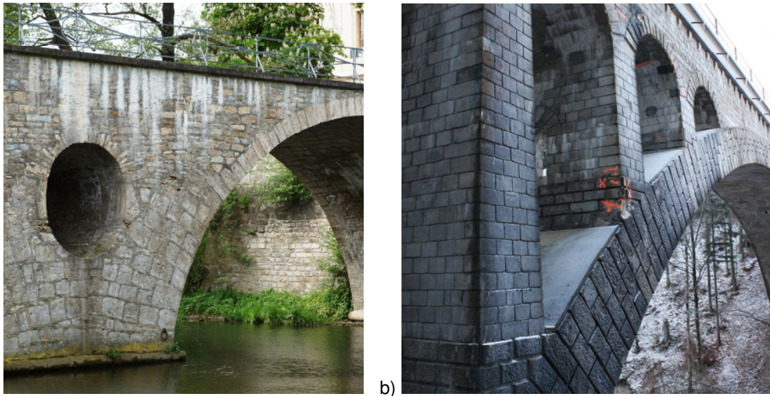
Abbildung 6: Beispiel a) für ein Spargewölbe in Längsrichtung (Sternbrücke Weimar) und b) für offene Stirnmauern (Schalchgraben-Brücke Österreich)
