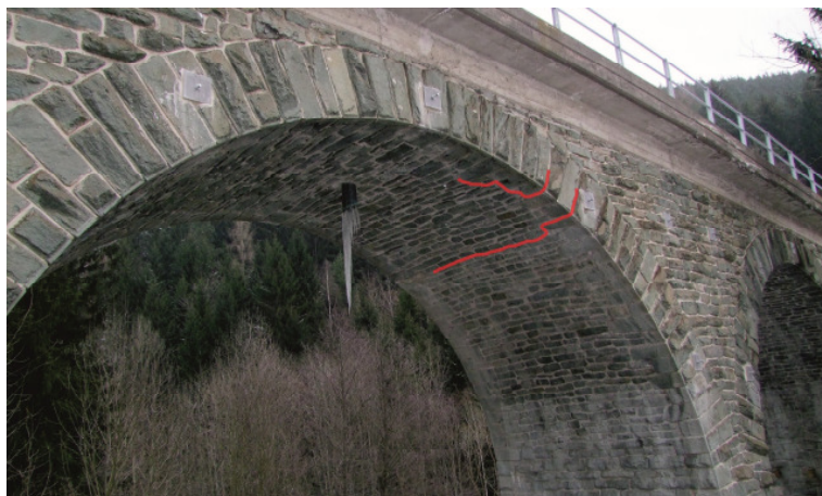
Abbildung 107: Vorhandenes Schadensbild der Beispielbrücke 1
