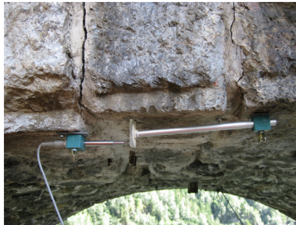
Abbildung 115: Vorhandener Riss in einem Gewölbe der Beispielbrücke 3 (mit appliziertem Verschiebungssensor zu Rissöffnungsmessung); Foto: Marc Gutermann
