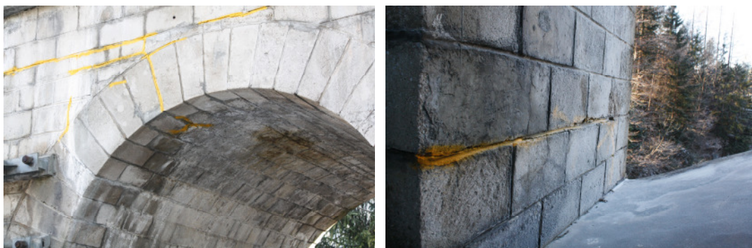
Abbildung 111: Vorhandenes Schadensbild an der Beispielbrücke 2; Riss in einem der kleinen Gewölbe (links) und Riss in einem Pfeiler der kleinen Gewölbe (rechts)
