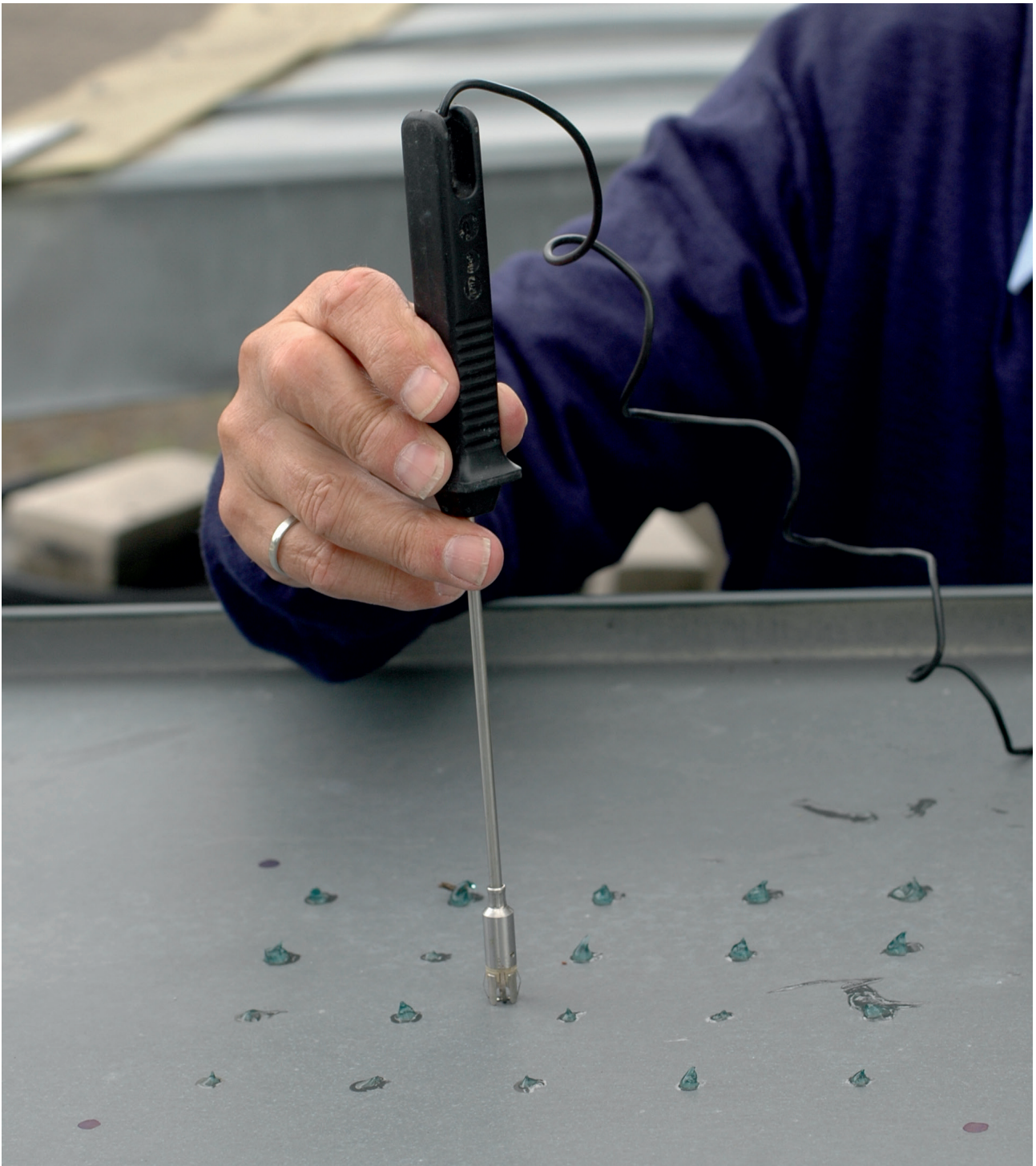
Abbildung 30: Temperaturmessungen der Titanzinkdeckung im Bereich des Messortes mit einem Kontaktthermometer. Jede Temperaturmessung wurde mit einem zweiten Messgerät kontrolliert.
