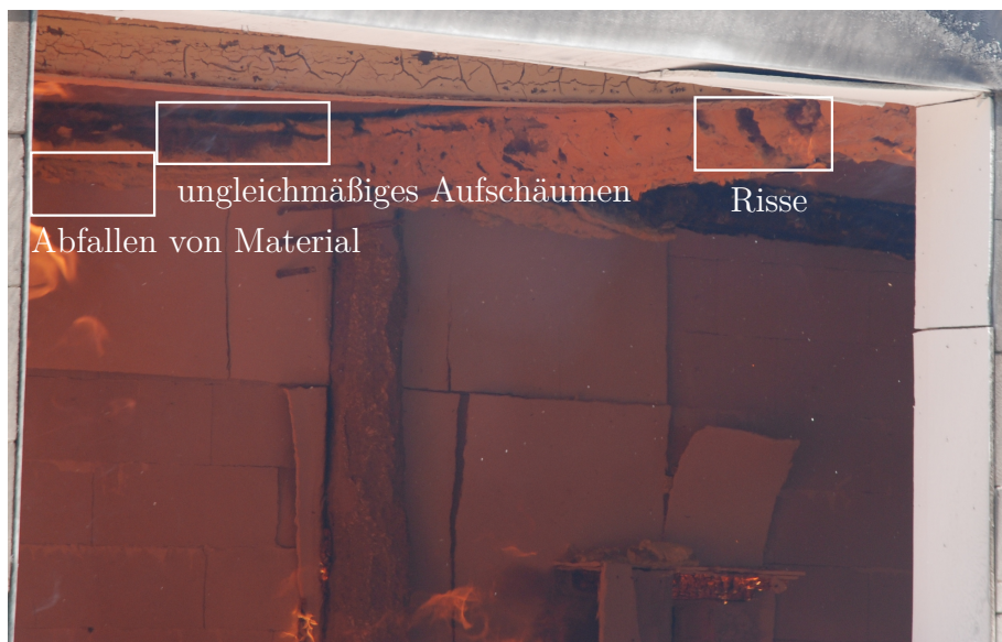
(a) Schädigungen am reaktiven Brandschutzsystem Beispiel 1
