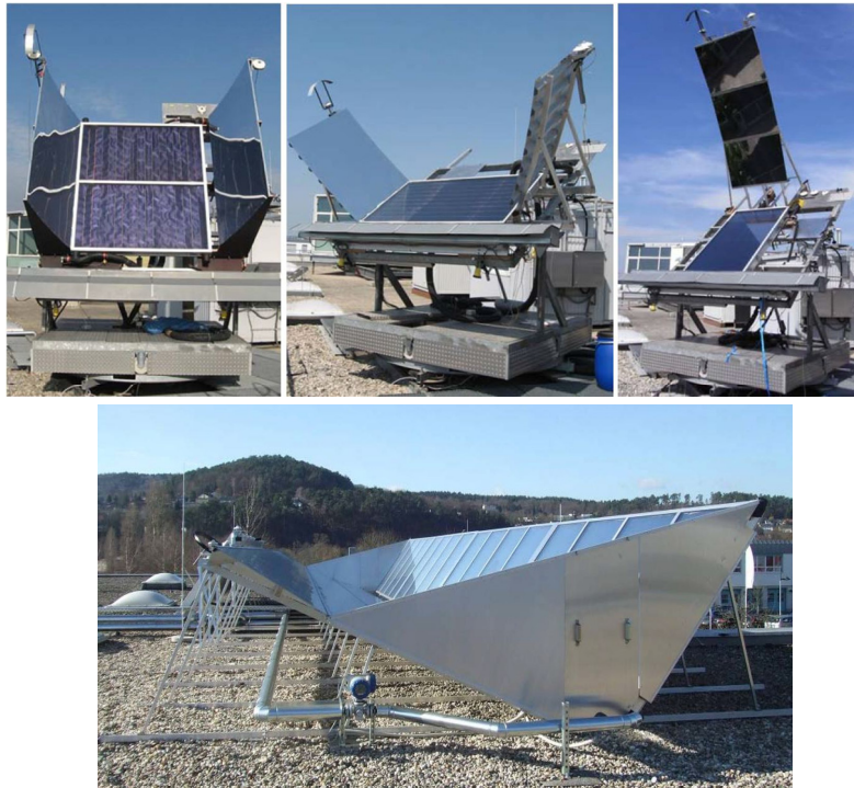
Abbildung 3.3: Flachkollektorkonstruktion mit externem Reflektor. Oben: Verschiedene Prototypstadien im Outdoor-Prüfstand. Unten: Installiertes Kollektorfeld (Heß 2010, Eisenmann 2011)
