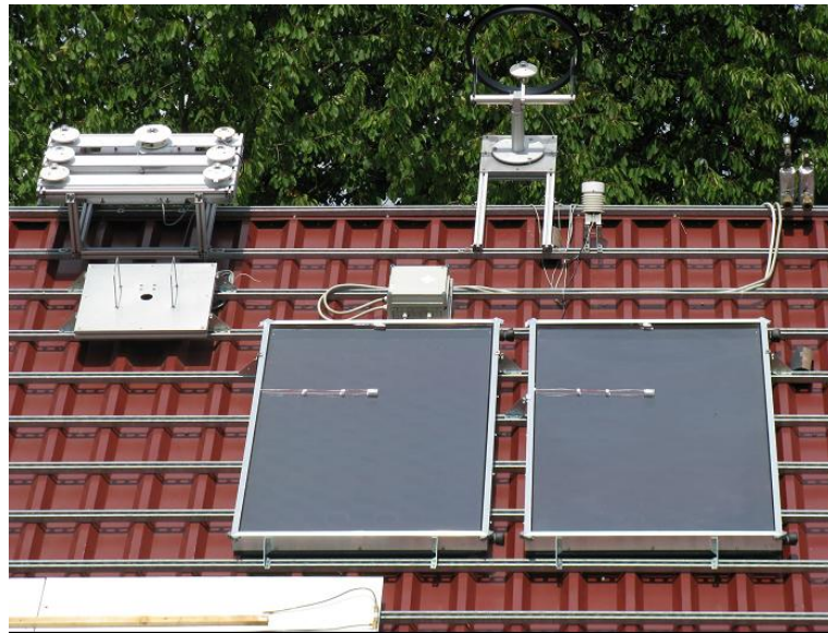
Abbildung 8.35: Stagnierende Kollektoren zur Langzeitexposition auf dem Testdach des ISFH.
