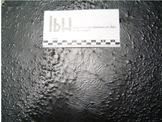
Abb. 37: Unzureichender Verlauf bei einer Parkdeckbeschichtung
