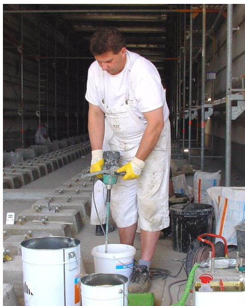
Abb. 42: Anmischen von Epoxidharzmaterial auf der Baustelle ohne ausreichenden Augen- und Hautschutz
