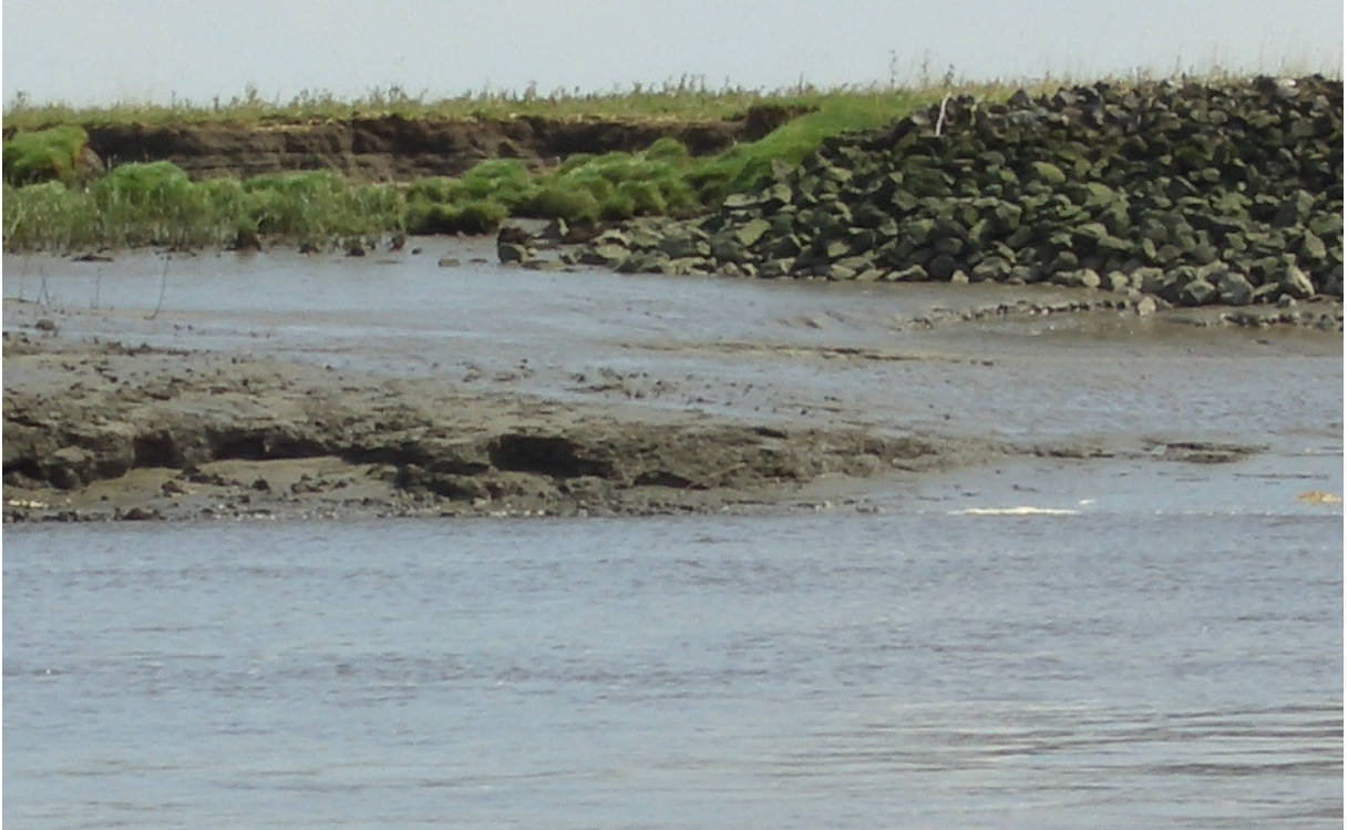
Abbildung 17: Zerstörung naturnaher Uferbereiche durch Steinschüttungen an der Unterelbe/Ostemündung (FELDT 19. Juli 2007)
