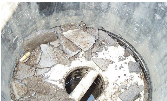
Abb. 94: Ablagerungen auf der Lava- Filteroberfläche
