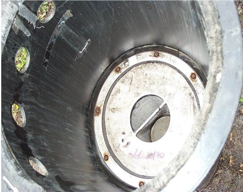
Abb. 107: Edelstahlfilter nach Spülung
