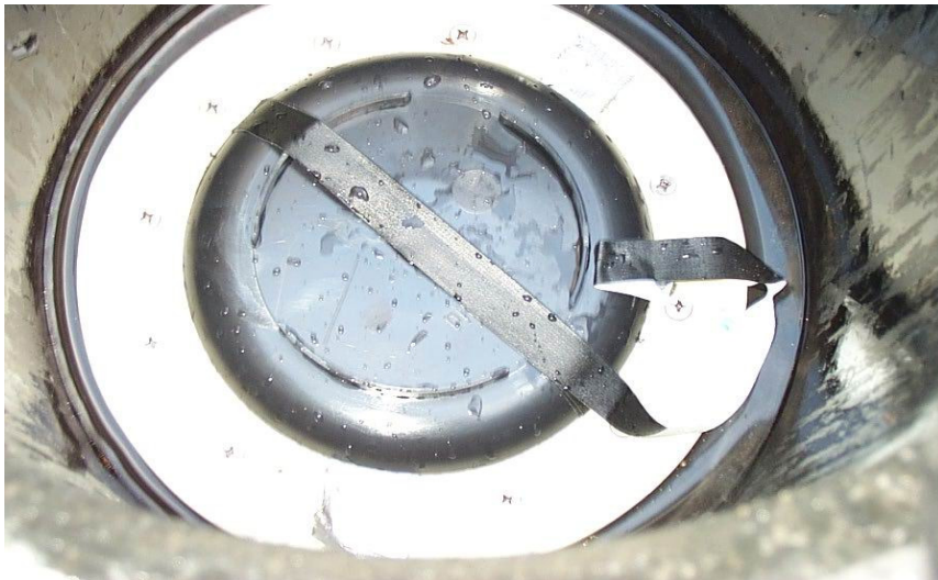
Abb. 99: „Stöpsel“ zum Einstauen nach der Spülung
