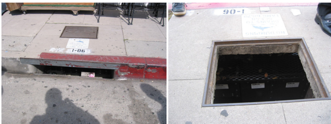
Abb. 40: Schmutzfänger die Verhindern dass die in den Gully gelangenden Abfälle im Straßeneinlauf in den Kanal weiter getragen werden.
