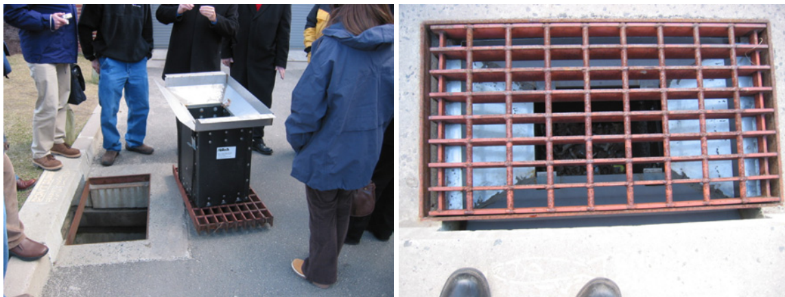
Abb. 39: Schmutzfänger zum Sammeln der in den Gully gelangenden Abfälle im Straßeneinlauf
