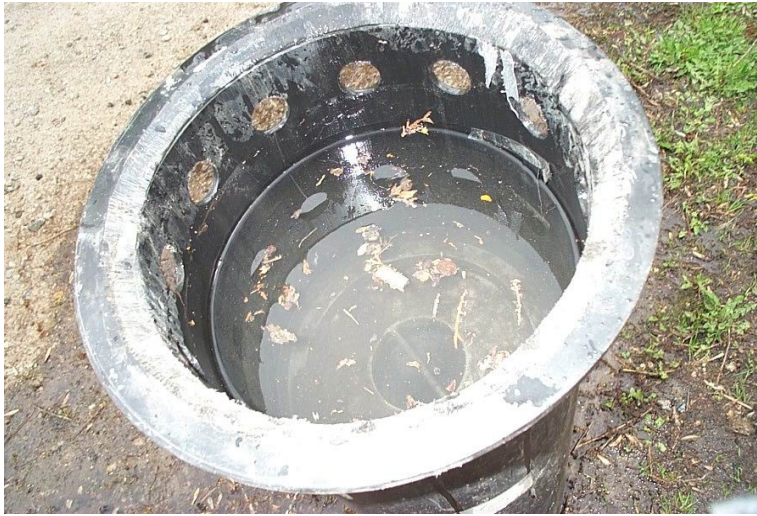
Abb. 102: Edelstahlfilter vor der Spülung
