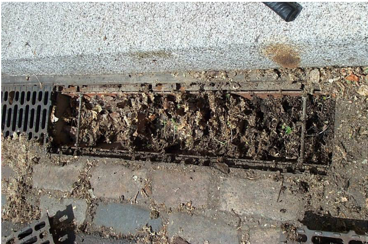
Abb. 83: Verschmutzung des Grobschmutzfanges in INNOLET®-Rinne durch Straßenschmutz und Laub, Berlin-Krachtstr.
