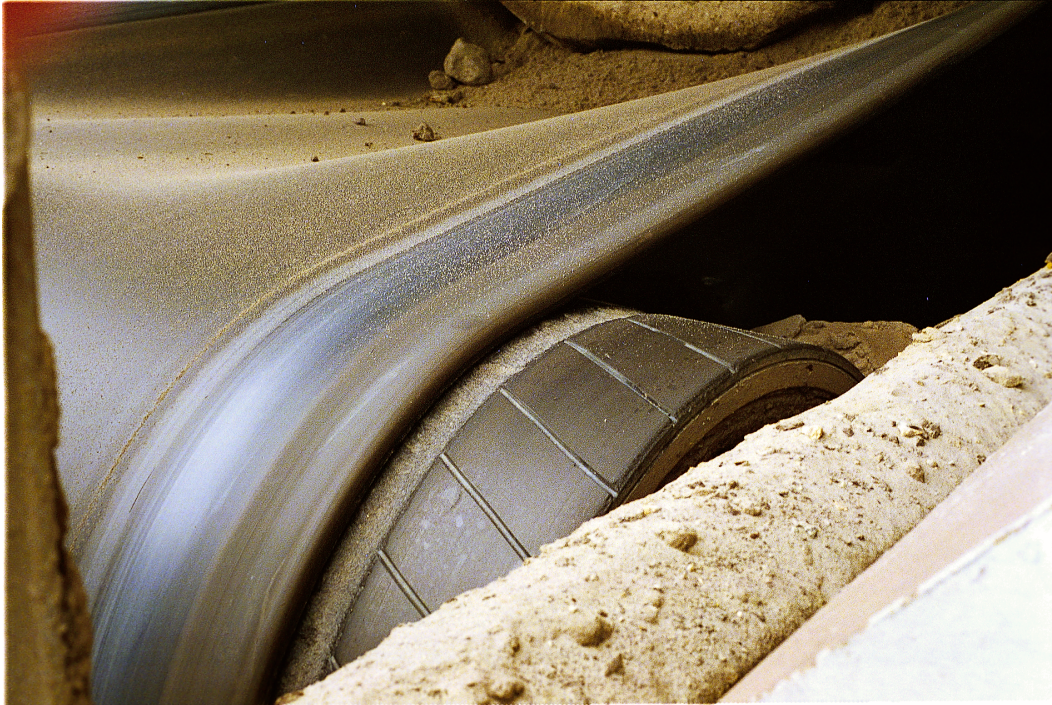
Bild 1.1: Verschleiß der Belagsoberfläche im Randbereich des Trommelbelags.
