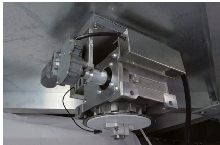
Abbildung 2: Elektromotor unterhalb des GTEM-Zellenbodens
