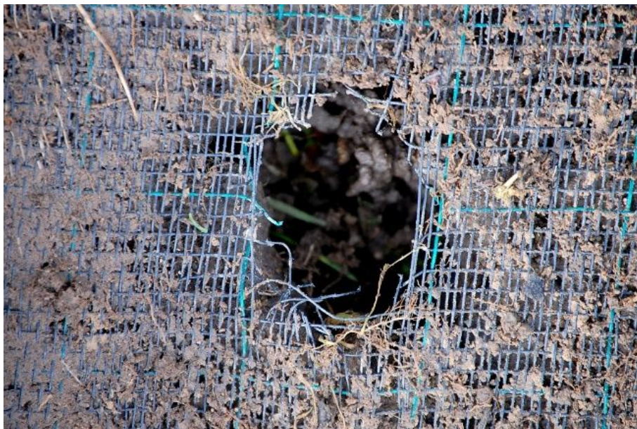
Abb. 63: Wühlmausverbiss einer horizontalen Barriere, Material rund ausgenagt
