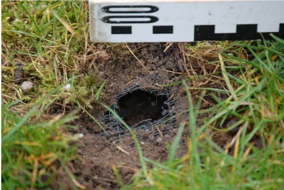
Abb. 28 a: Durchdringung der horizontalen Barriere durch eine Wühlmaus. „Durchbruch“ im Gewebe randscharf und rund zerfressen
