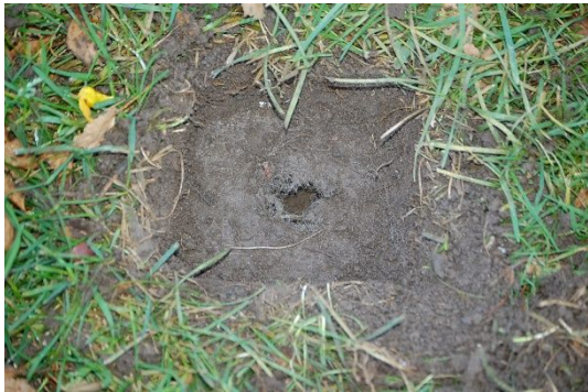
Abb. 31 c: Freigelegte beschädigte Barriere
