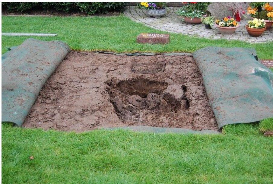
Abb. 29 c: Ausmaß des Grabeinbruchs, freigelegte Einbruchstelle. Aufgetrennte horizontale Barriere als Vorbereitung der Instandsetzung
