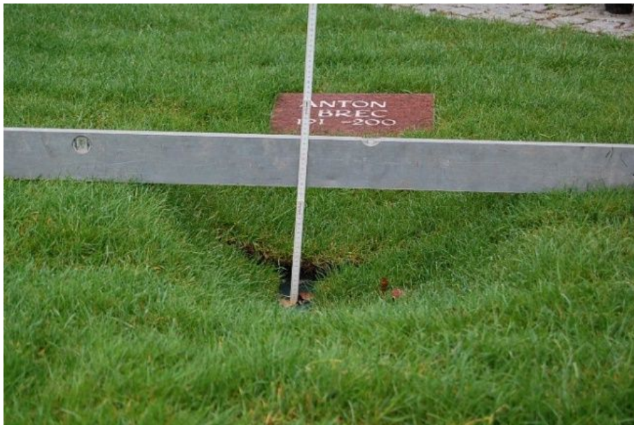
Abb. 29 a: Eingebrochenes Grab 5 in einer Rasenreihengrabanlage, das durch die Barriere überspannt wird
