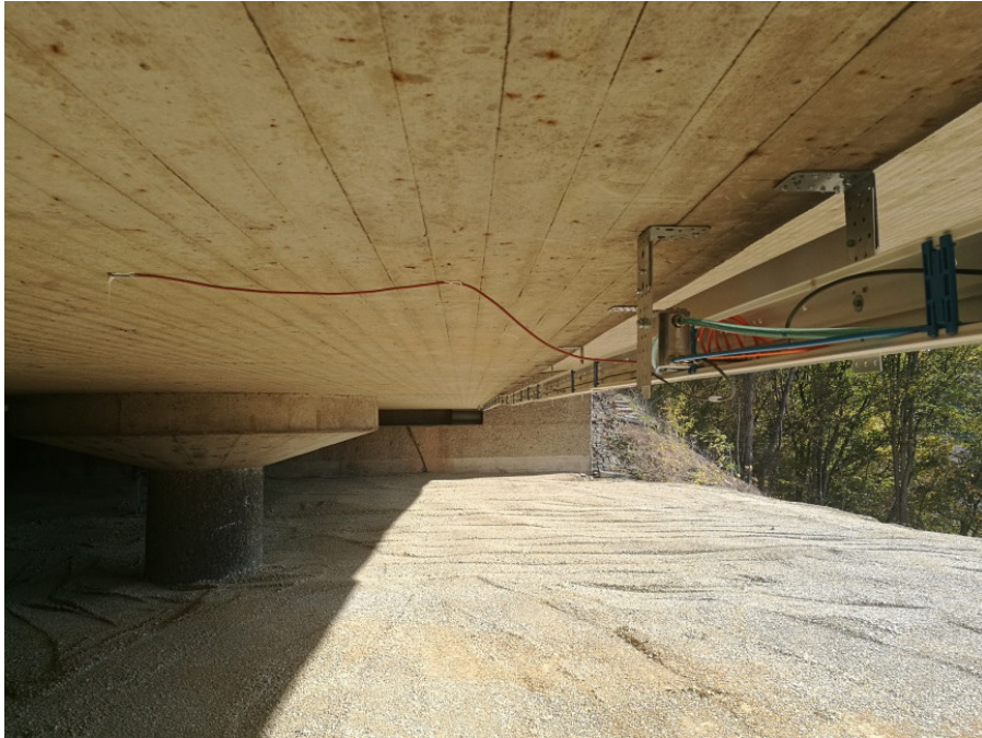
Abbildung 5: Schlauchwaagendrucksensor und Temperaturfühler
