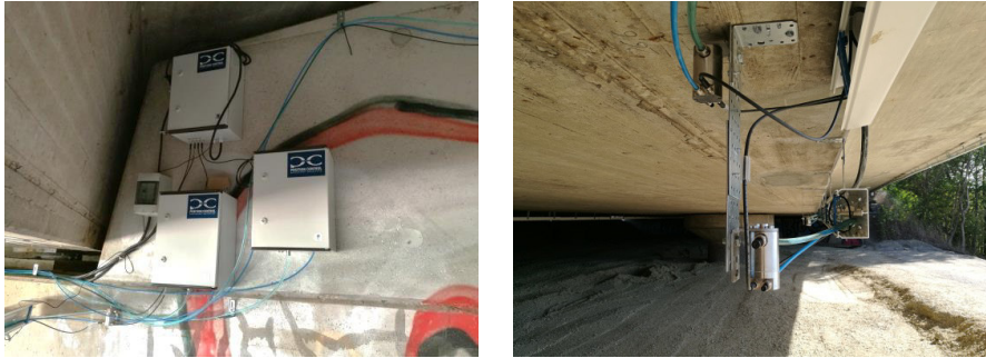
Abbildung 6: Datenlogger und Ausgleichgefäße (links), Übergabepunkt zwischen zwei Messlinien (rechts)
