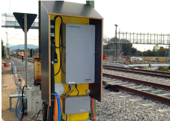
Abbildung 2: Typische Installation der Messzentrale
