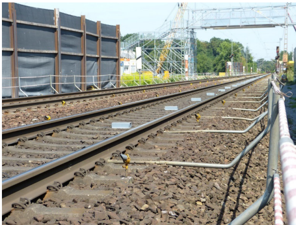
Abbildung 7: Installierte Messsysteme (geodätisch und geotechnisch)
