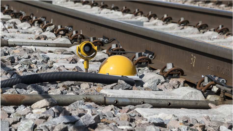
Abbildung 22: Kombination von Gleisprisma, TrackControl Sensoren und GNSS Sensor
