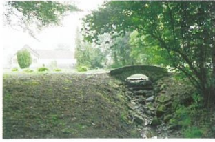
Restaurierte Brücke und gesicherter Wasserlauf im Park des Gutes Walshausen nach denkmalpflegerischen Maßnahmen, 1998 (Foto Rainer Schomann)
