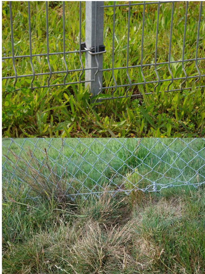
Abb. 62: Durch Geländeunebenheiten und den Versatz von Zaunelementen ergeben sich unterschiedlich große Abstände zwischen Boden und Zaun (oben: Anlage 363, Cremlingen). Oft werden die Zäune von Kleinsäugetieren zusätzlich untergraben (unten: Anlage 24, Gerdshagen).
