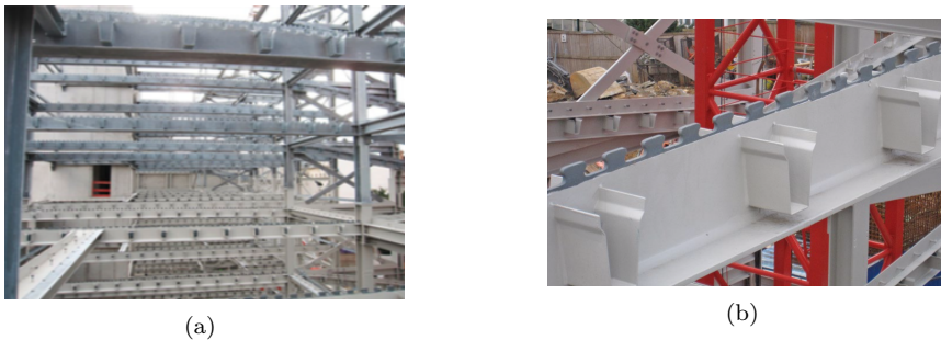
Abbildung 2.9: Parkhaus Coulinstraße in Wiesbaden: (a) Stahlkonstruktion ( Springer et al., 2018 ), (b) Oberflanschlose I-Profile mit VDL ( Springer et al., 2018 )
